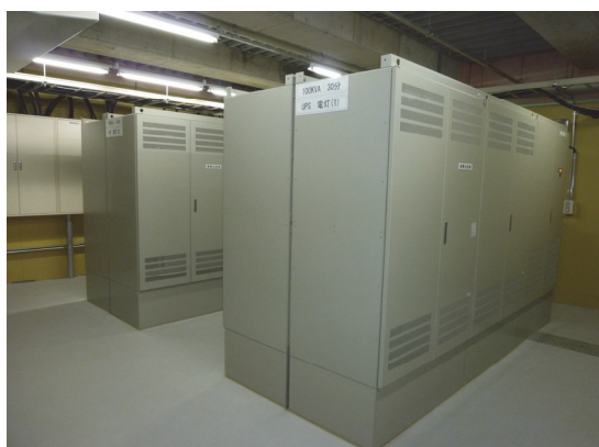
図6. 大型 UPS 装置
