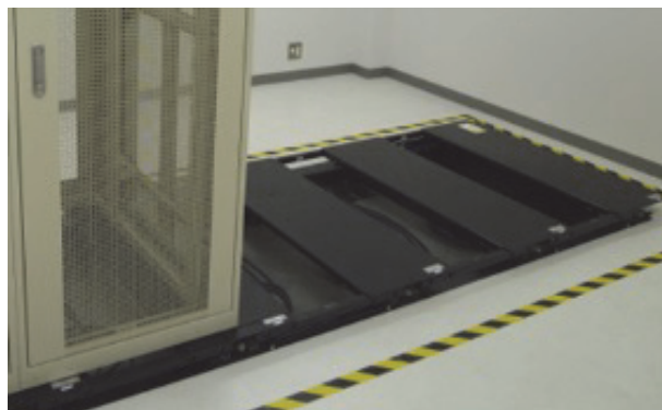
図3 免震台とラック
