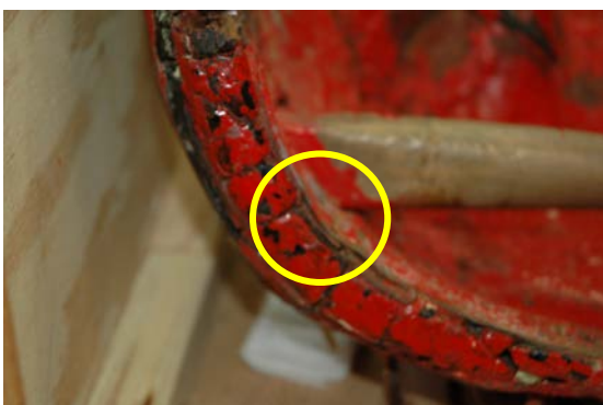
0725-41 鉄板の切断箇所 鉄板は二重になっており、下になっている 鉄板が二か所割れている。右側の割れ目で 切断することになった。
