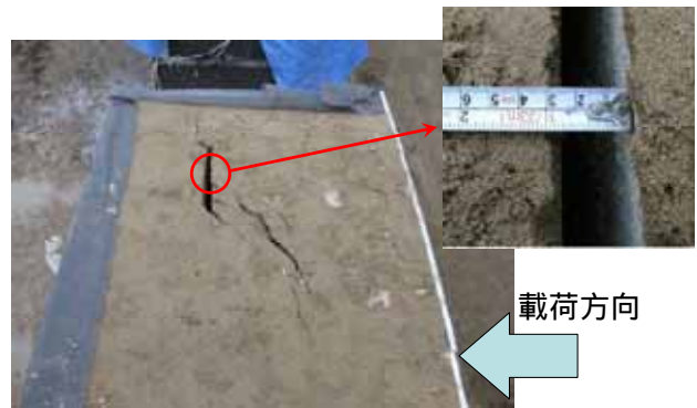
図-14 補強土体天端の除荷後の杭と補強土との隙間
