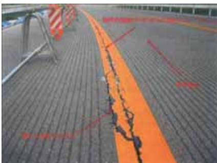
写真-2 切土作業中に一部路面に発生した亀裂
