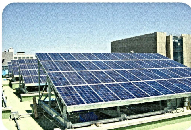
△理学部2号館屋上に設置された太陽光発電装置
